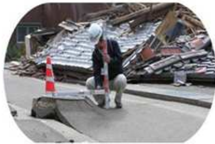
倒壊家屋とマンホール
