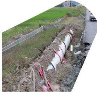
浮上した管路
