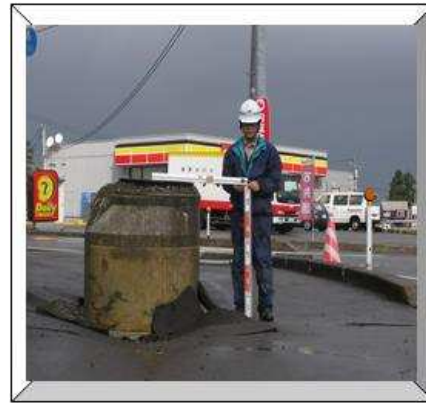
1m浮上したマンホール
