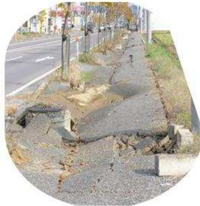
地表が陥没した管路
